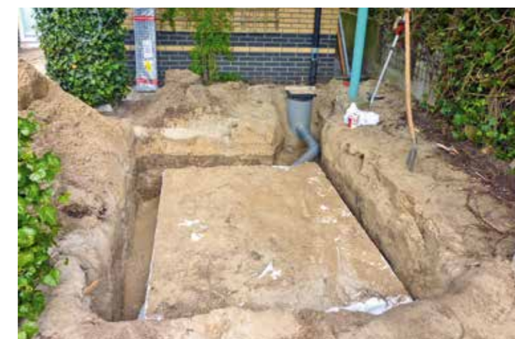
De regenpijp is aangesloten op een zandvangput, van hieruit loopt het regenwater via een buis direct de infiltratiekratten in. Omdat alles onder de bestrating van de oprit komt, is er na de aanleg niets meer van te zien.
