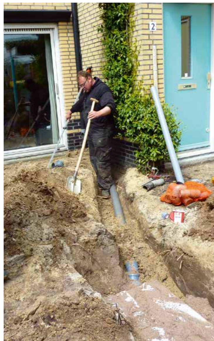
Om de bergingscapaciteit te vergroten worden twee infiltratieblokken naast elkaar geplaatst. Infiltratievoorzieningen geven overigens geen waterbuffer voor de beplanting, het is bedoeld als infiltratie en drainage van het hemelwater. De grond kan in droge periodes zelfs droger zijn boven infiltratiekratten.
